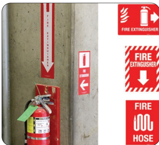
شکل ۹- مدیریت دیداری در نصب تجهیزات و برجسب‌های استاندارد اطفاء حریق [۹]
